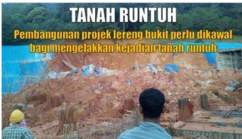
Gambar Rajah 5.3.1: Tanah berlaku akibat pembangunan projek dilaksanakan di lereng bukit tanpa kawal.
